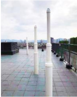
(改良后屋面排气管)
